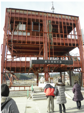
鉄骨だけが残る南三陸町志津川防災庁舎。殉職した職員を悼む献花が絶えない。
